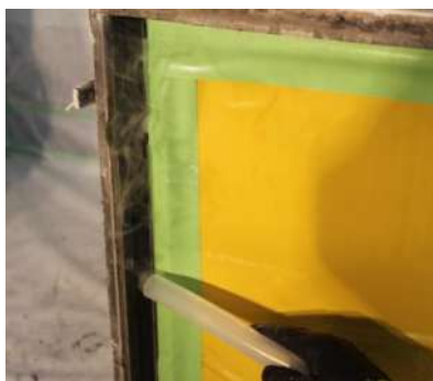
図 4.7.49 HEPA フィルタ 周辺部分
