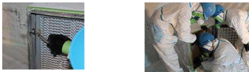
図 4.7.84 HEPAフィルタの留め付の緩み点検
