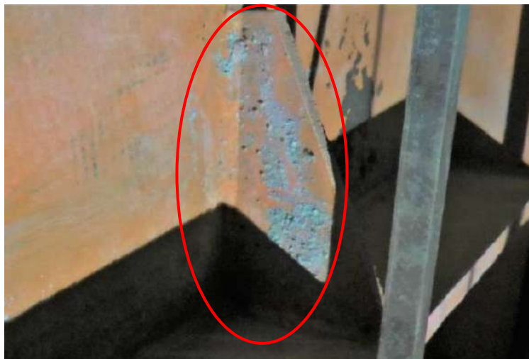
鉄骨梁側面の取り残し
