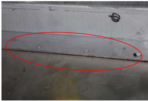
HEPA フィルタ取り付け面
