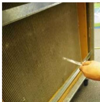
図 4.7.48 HEPA フィルタ面
