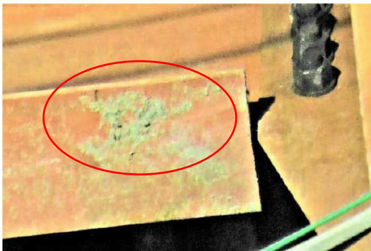
鉄骨梁下の取り残し
