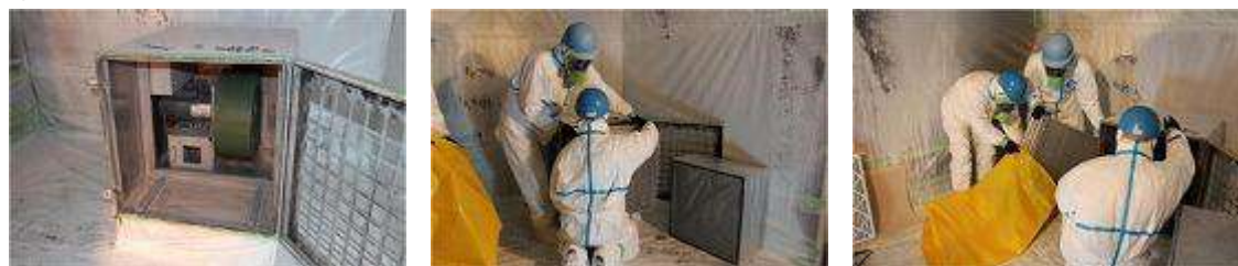
図 4.7.85 HEPAフィルタの交換
