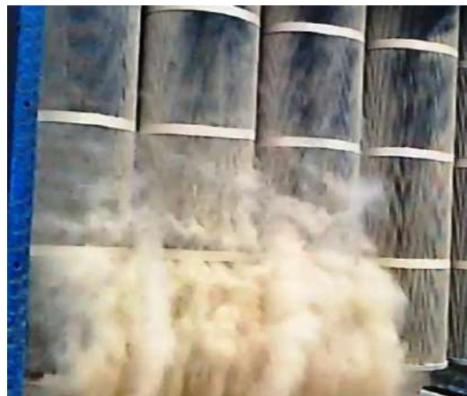
写真Ⅲ－３ フィルタ自動再生状況
