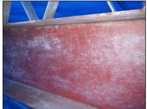
図 4.7.70 再付着した石綿の例
